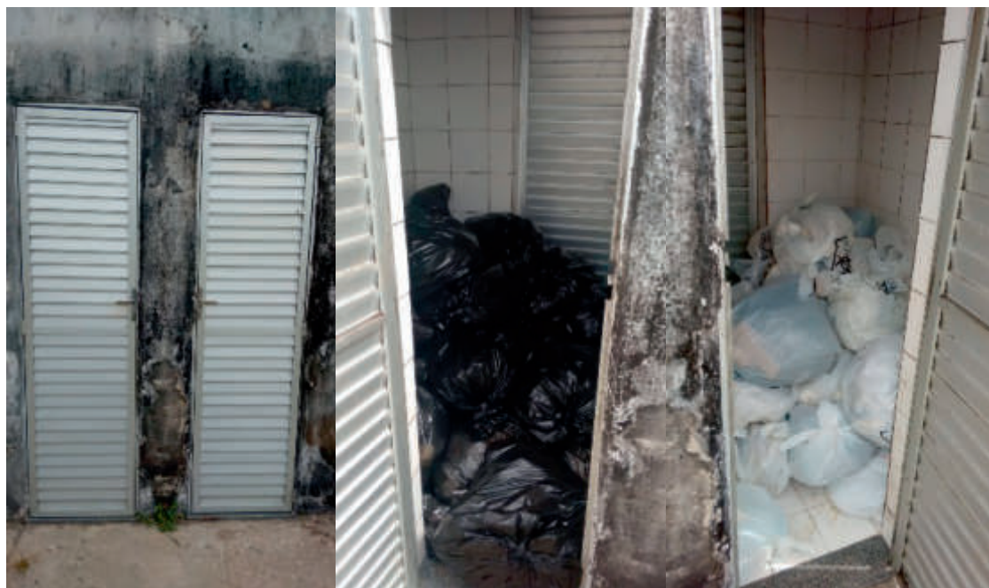
Figura 76: Depósito temporário para RSS, unidade de saúde de Rosário do Catete Crédito da foto: M&C Engenharia (2015)
