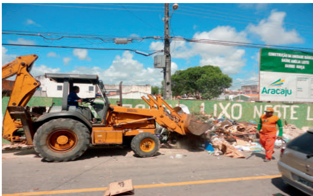
Figura 26: Remoção de resíduos acumulados – Aracaju/SE
