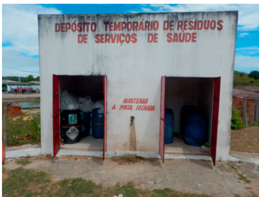
Figura 77: Depósito temporário para RSS, unidade de saúde de Laranjeiras Crédito da foto: M&C Engenharia (2015)
