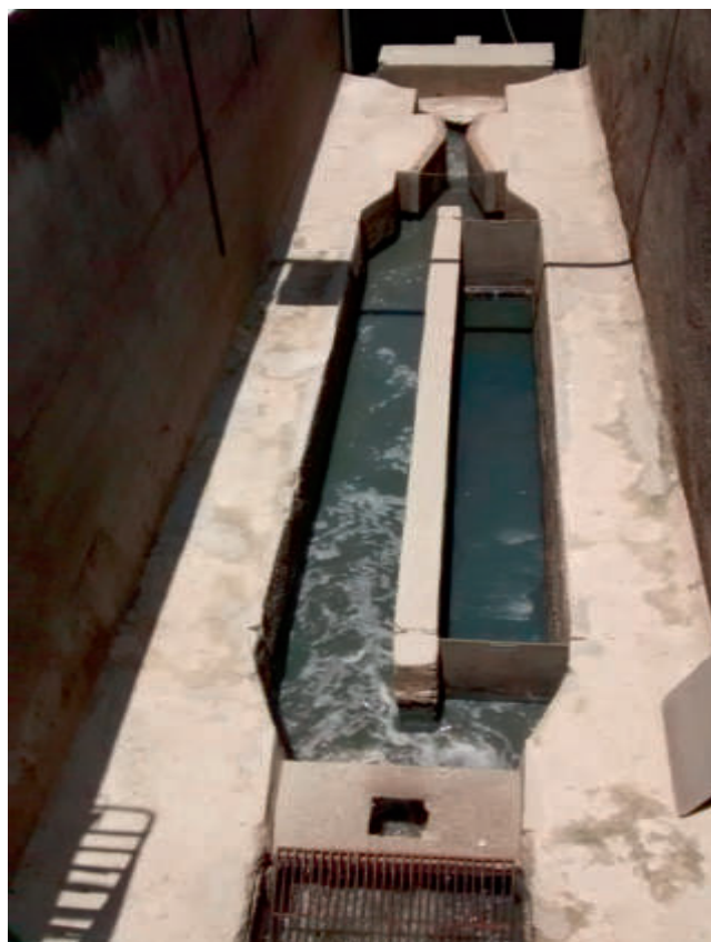
Figura 65: Caixa de areia – ETE Orlando Dantas
