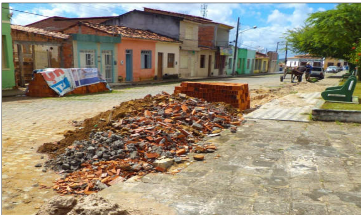
Figura 31: RCC acumulados em via pública – Siriri/SE.
